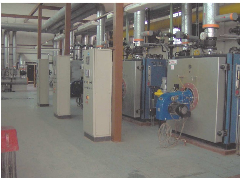
Technologické zařízení kotelny OKD na ul. Čs. armády
