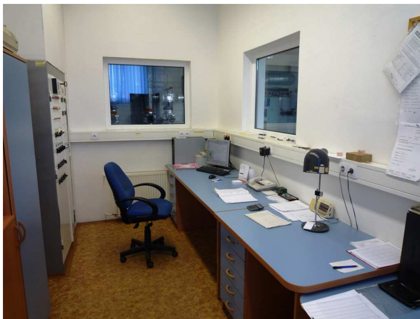
Dispečerské pracoviště na kotelně OKD na ul. Čs. armády
