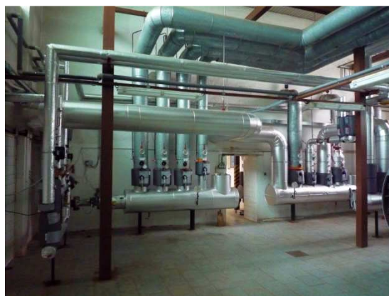
kotelna OKD po rekonstrukci
