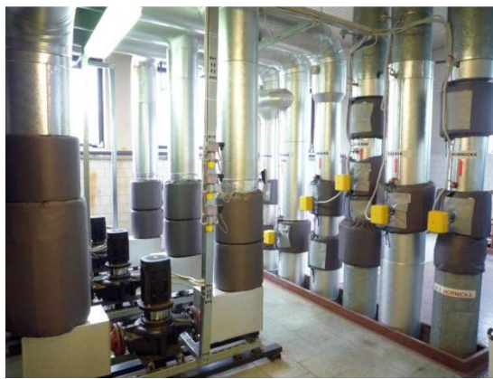
kotelna OKD po rekonstrukci
