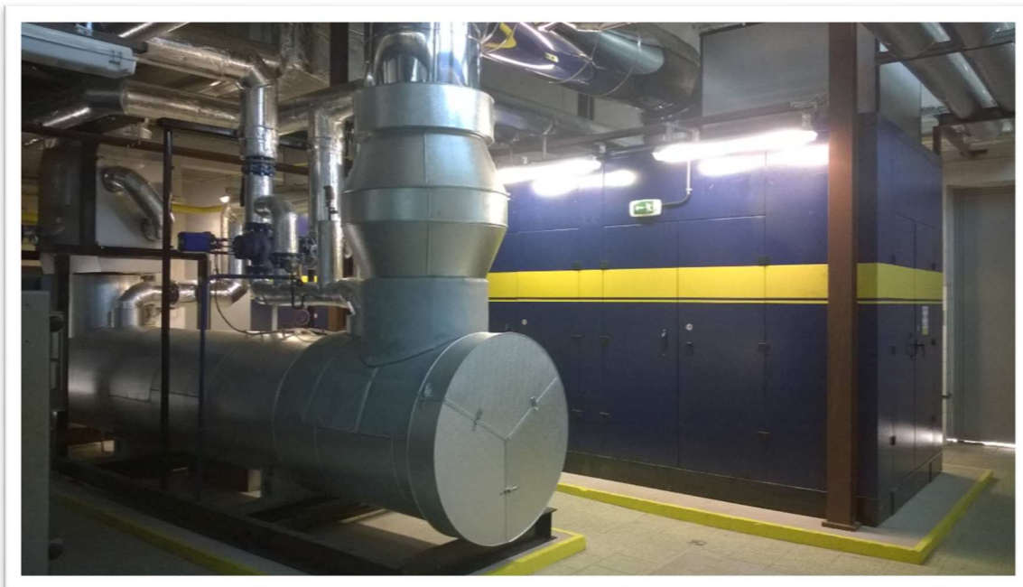
Kogenerační jednotka TEDOM Quanto 1600 v kotelně OKD na ulici Čs. armády1263/32
