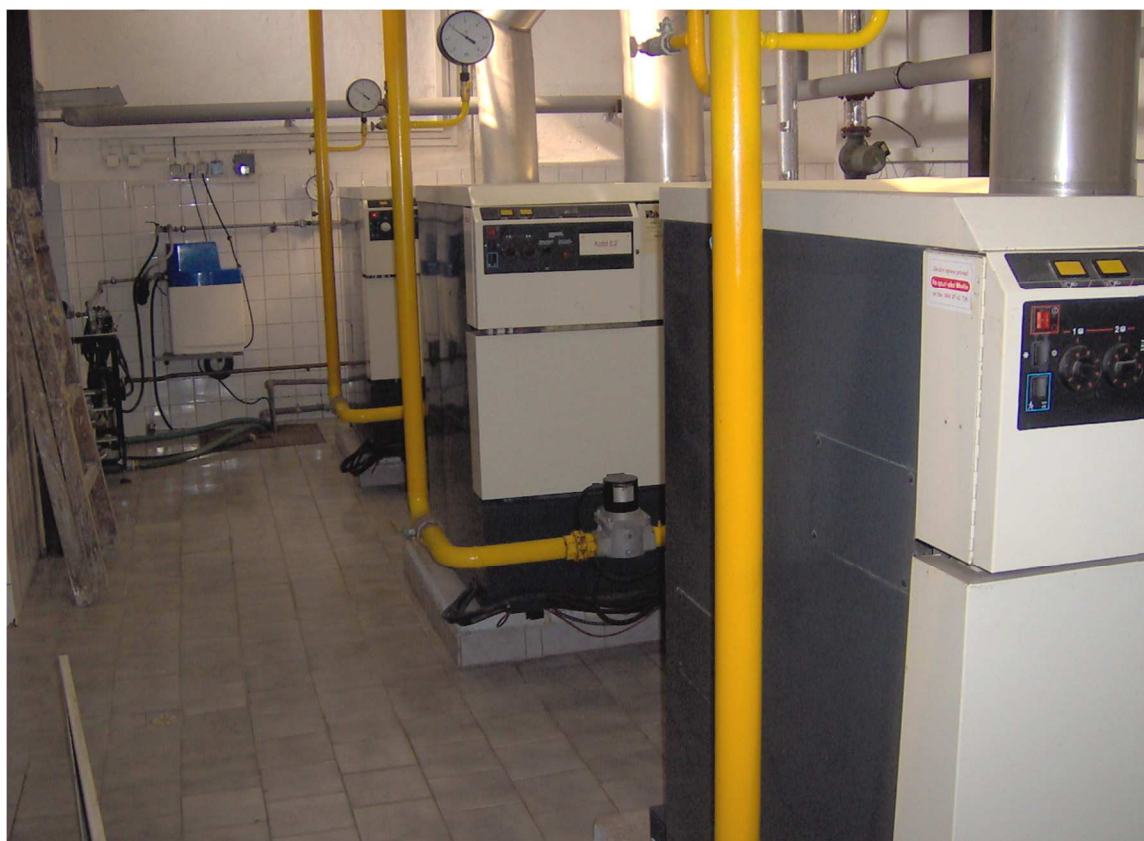
Kotelna na Zahradní ulici před rekonstrukcí
