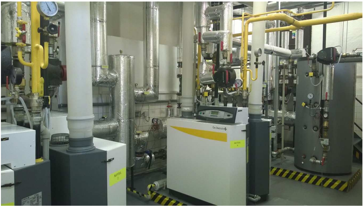
Kotelna na Zahradní ulici po provedené rekonstrukci
