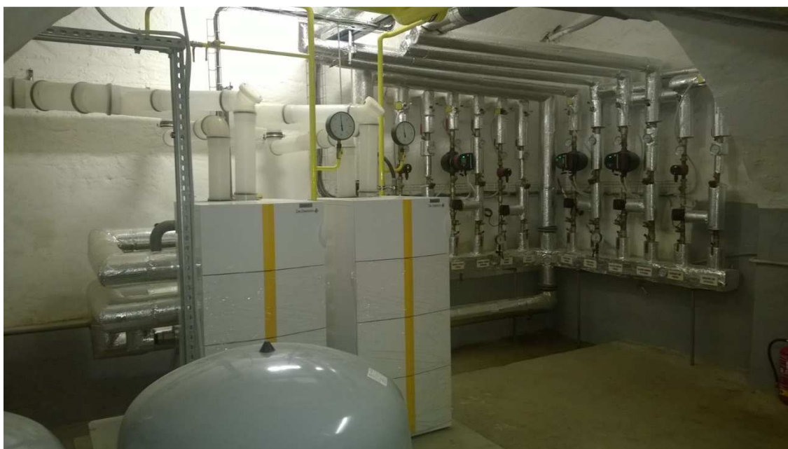
V roce 2015 rekonstruovaná kotelna v budově MěÚ I.
