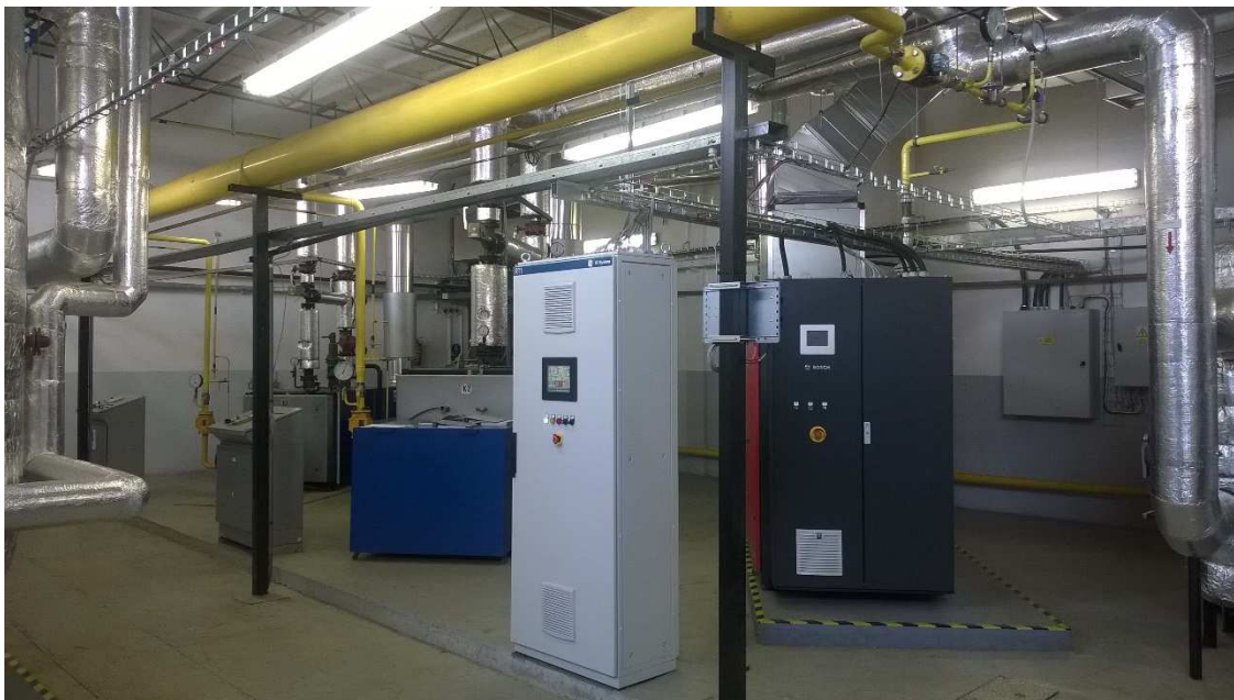
Nová kogenerační jednotka Bosch v kotelně Cihelní
