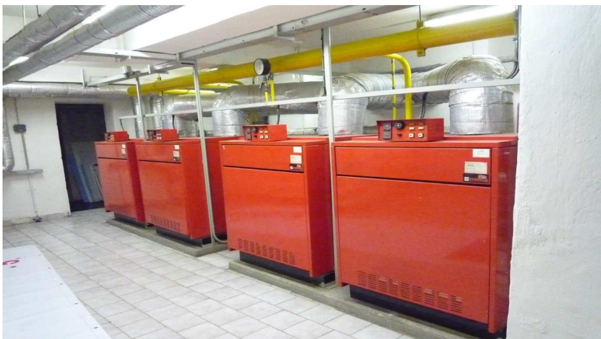
Kotelna v kulturním domě v Hlučíně
