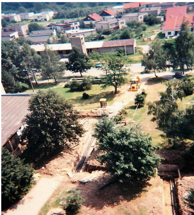
Rok 1998 - rekonstrukce teplovodních rozvodů na sídlišti Rovniny (v pozadí bývalá kotelna na ul. J. Seiferta I.)
