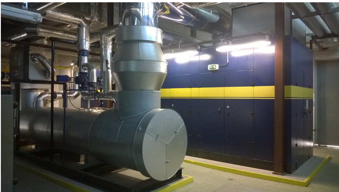
Rok 2013 – instalována kogenerační jednotka v kotelně OKD
