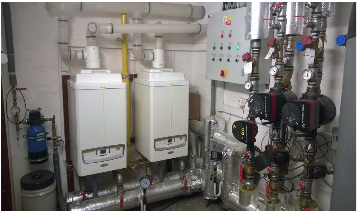
Rok 2016 - nově zřízena kotelna pro dům na ul. Zahradní 14 a Dr. E. Beneše
