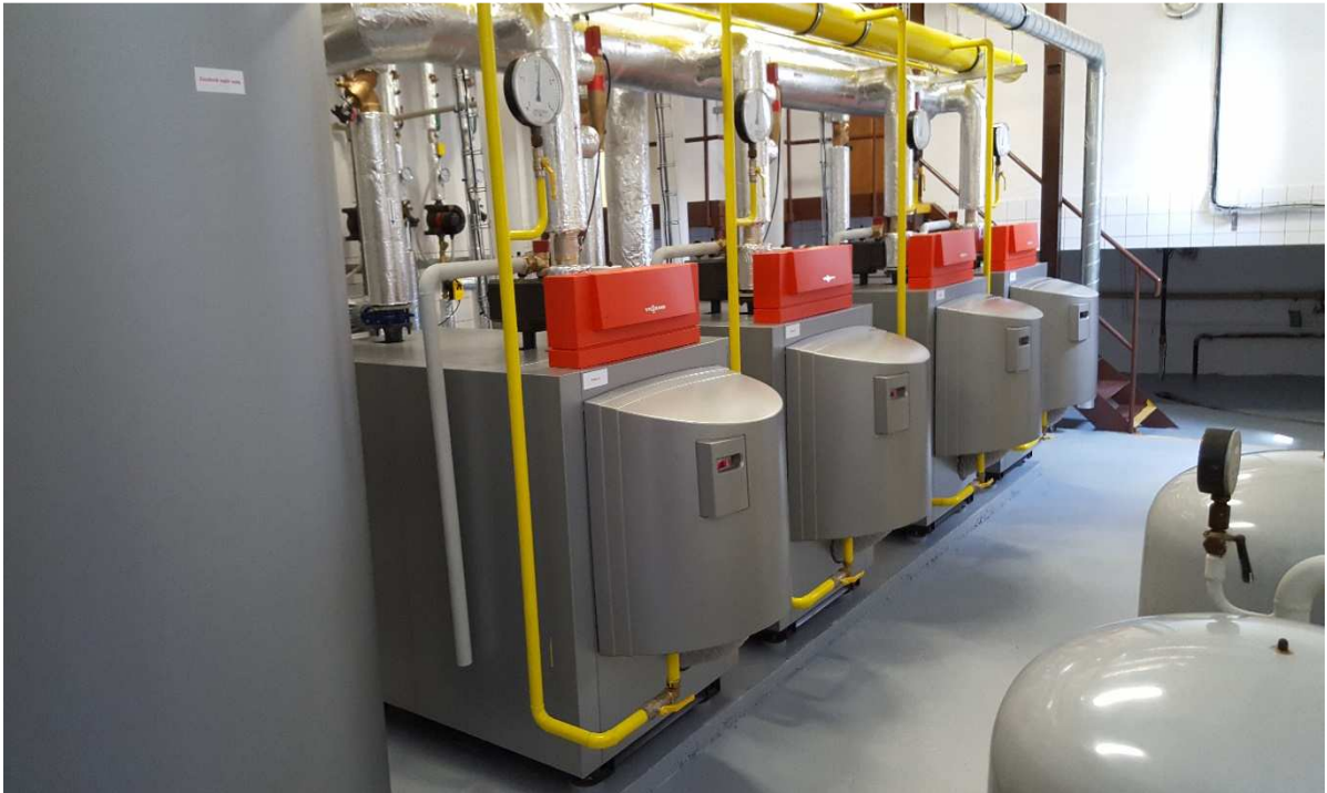
Rok 2016 - rekonstruovaná kotelna v budově ZŠ Dr. M. Tyrše
