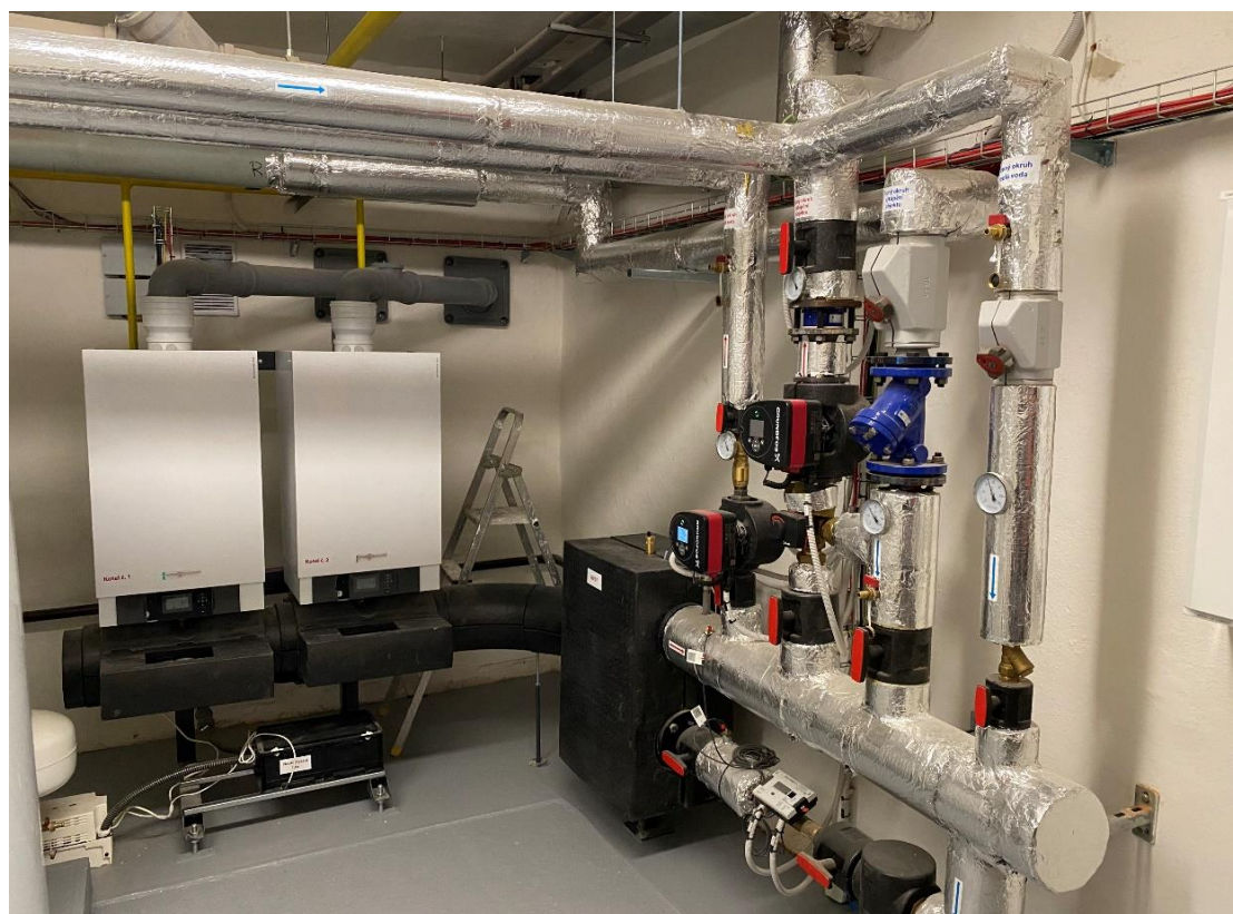
2021 – rekonstruovaná kotelna v budově Dětské rehabilitace Hlučín
