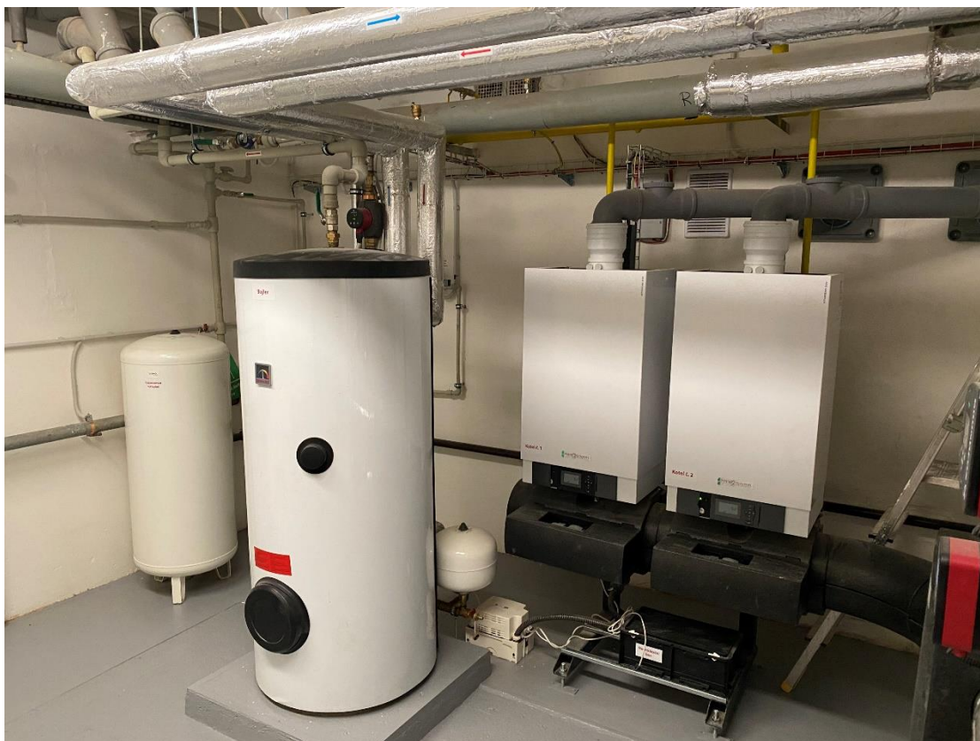
2021 – rekonstruovaná kotelna v budově Dětské rehabilitace Hlučín
