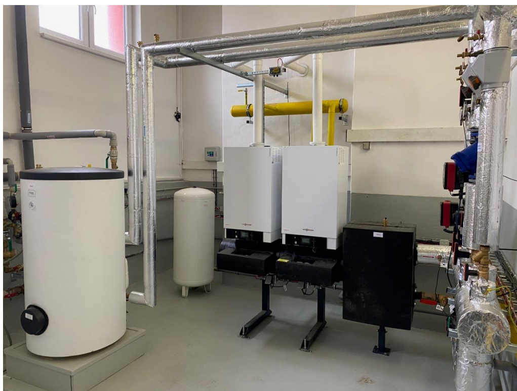
2022 – kotelna v budově MŠ Darkovičky po rekonstrukci
