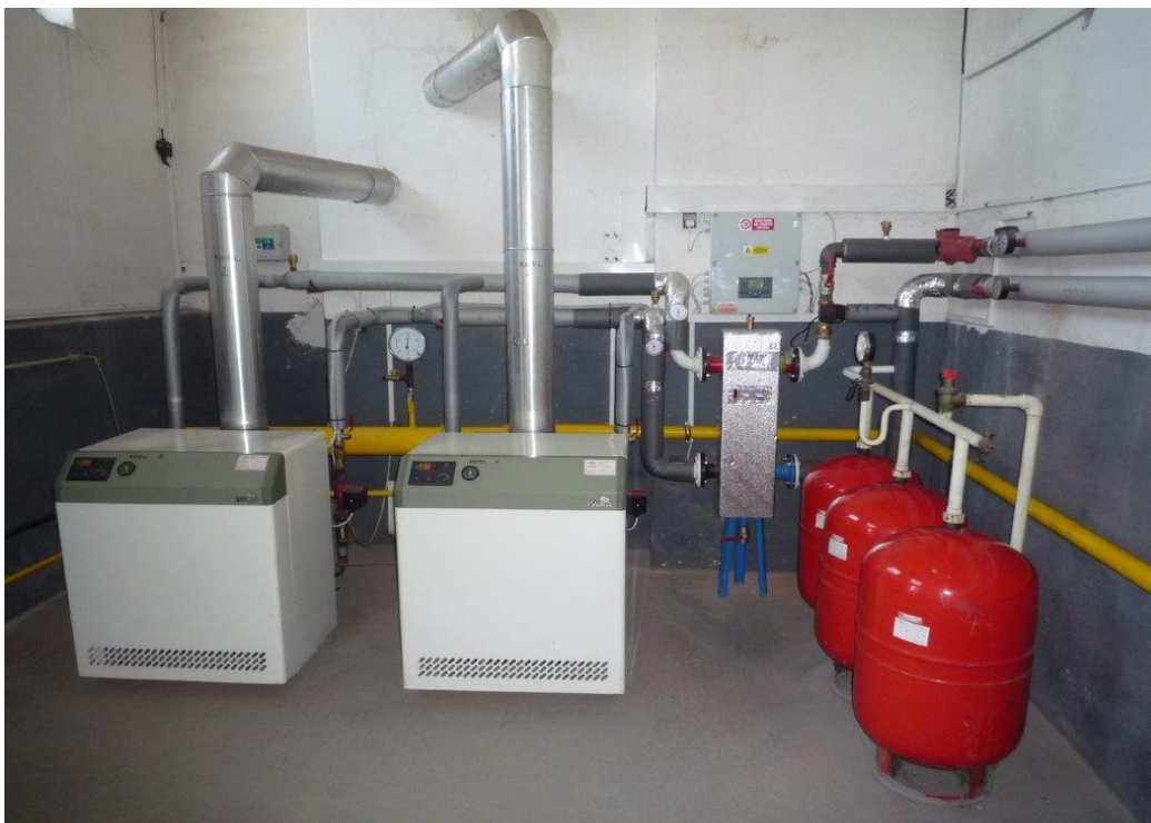
2022 – kotelna v budově MŠ Darkovičky před rekonstrukcí
