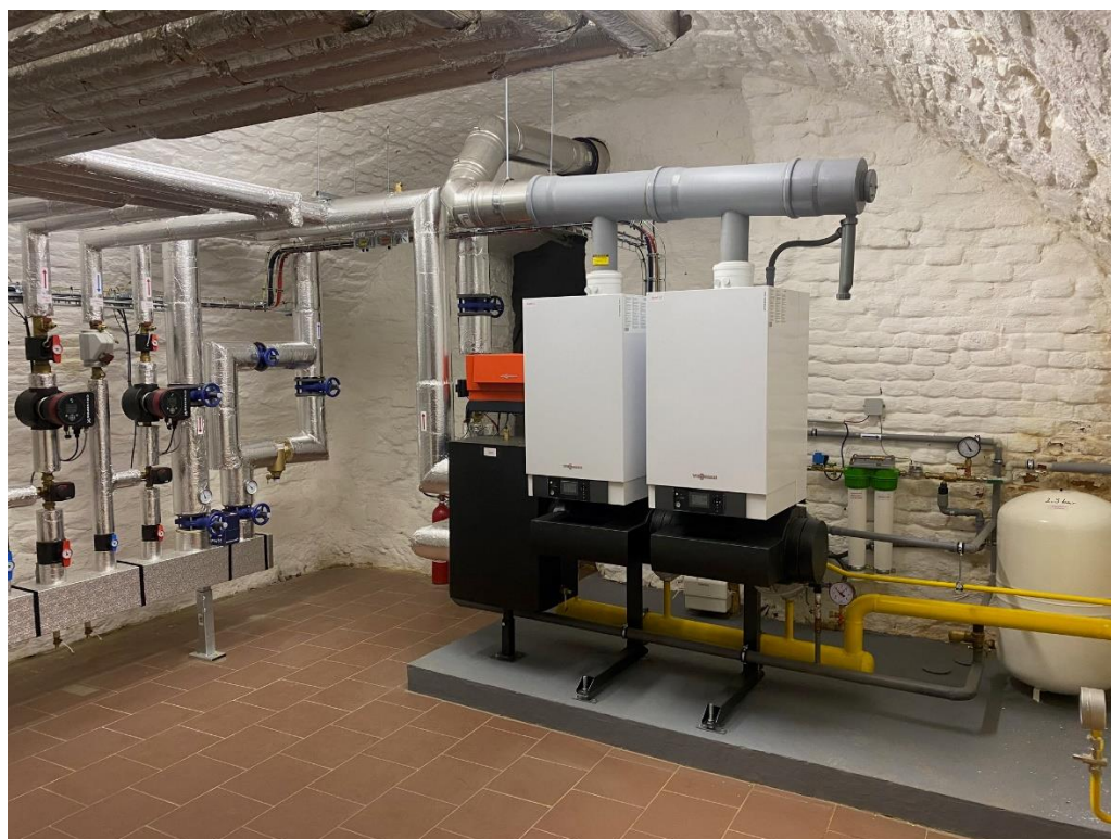
2023 – kotelna v budově hlučínského zámku po rekonstrukci
