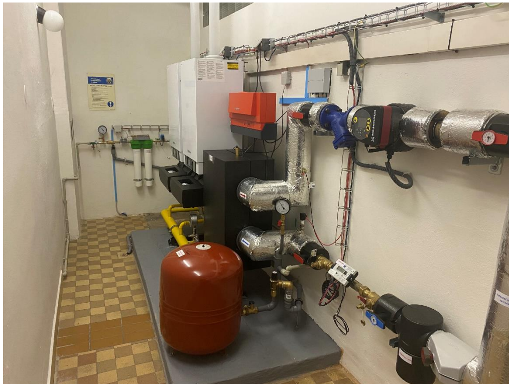
2023 – kotelna v budově ZŠ Darkovičky po rekonstrukci
