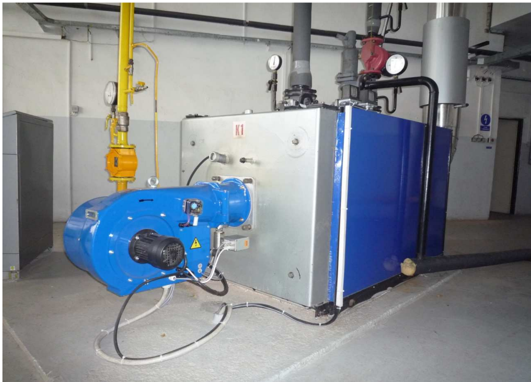
kotelna Cihelní – nový automatický plynový hořák s ventilátorem APH 400kW
