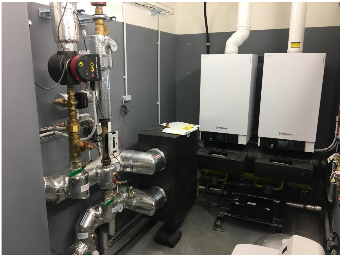
2020 – nová kotelna v bytovém domě na Mírovém náměstí 25 v Hlučíně
